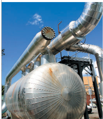
Le sécheur de Bouillante 2.
