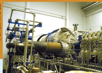
La turbine de Bouillante 2.
