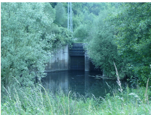
Déversement des eaux de la galerie du canal de Moyeuve dans l'Orne (S4)
