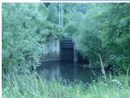
Déversement des eaux de la galerie du chenal de Moyeuve dans l'Orne (S4)
